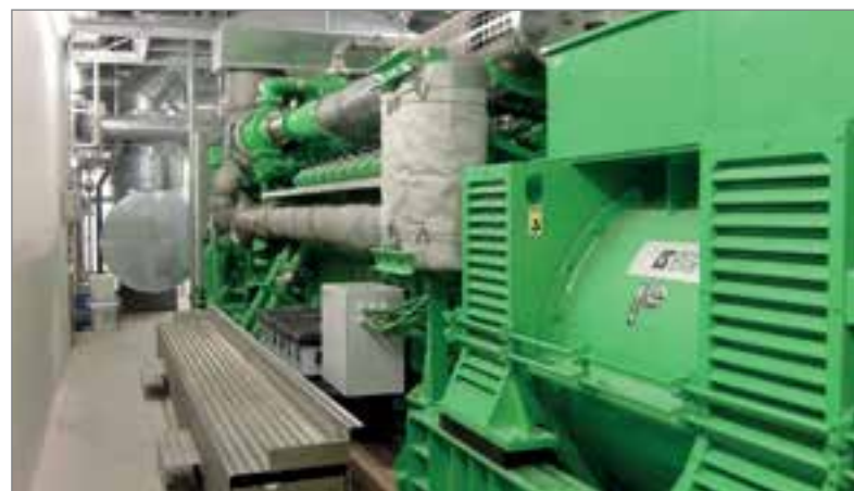
Blick auf einen der beiden neuen Motoren mit 4.4 MW
