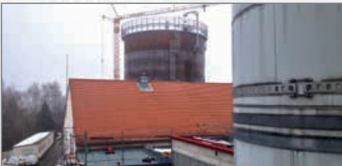
Blick auf den neuen Wärmespeicher
