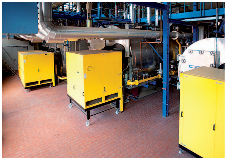
Das Kesselhaus 1 mit drei unterschiedlichen Erdgas-Kesseln (v.r.n.l.: 4/9,3/18,6 MW).
