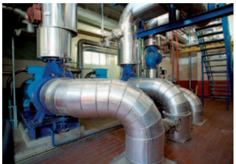
Ansicht der drei Hauptumwälzpumpen für das Fernwärmenetz in Freiberg.
