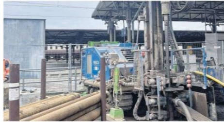
Am Freiburger Bahnhof hat am Donnerstag eine Probebohrung für die künftige Beheizung des Komplexes mit Erdwärme begonnen. FOTO: STADTWERKE FREIBERG
