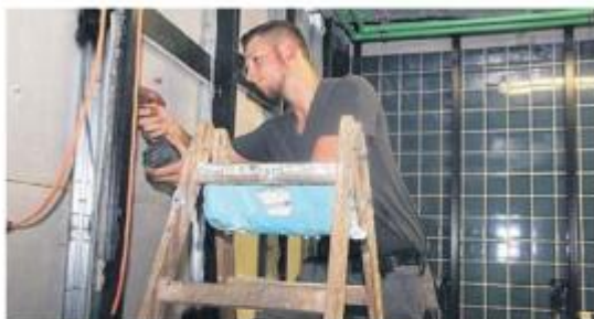
Neue Zuschnitte für die Duschkabinen: Anlagenmechaniker Vincent Stark von der Firma Käuffer beim Trockenbau in den künftigen Duschräumen.
