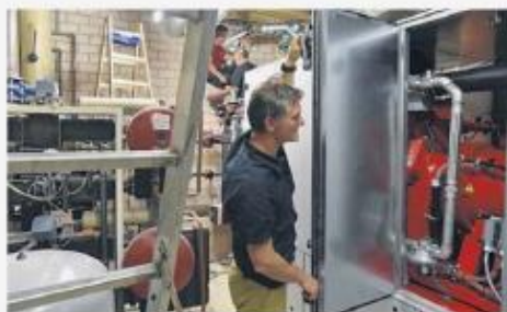
Das Blockheizkraftwerk im Johannistherme – hier Geschäftsführer Sylvio Diemel bei einer Kontrolle – hat eine Maximalleistung von 212 Kilowatt Wärme- und 138 Kilowatt Elektroenergie.
